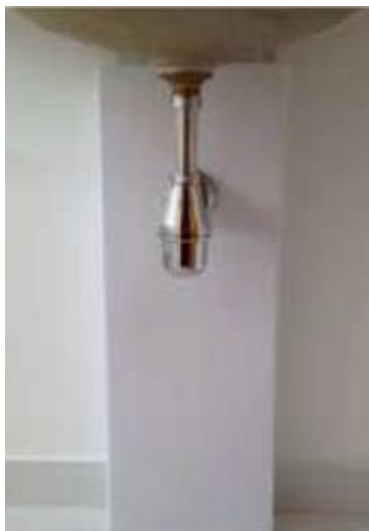
Tubulação embutida em carenagem
