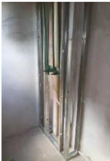
Shaft em dry wall
